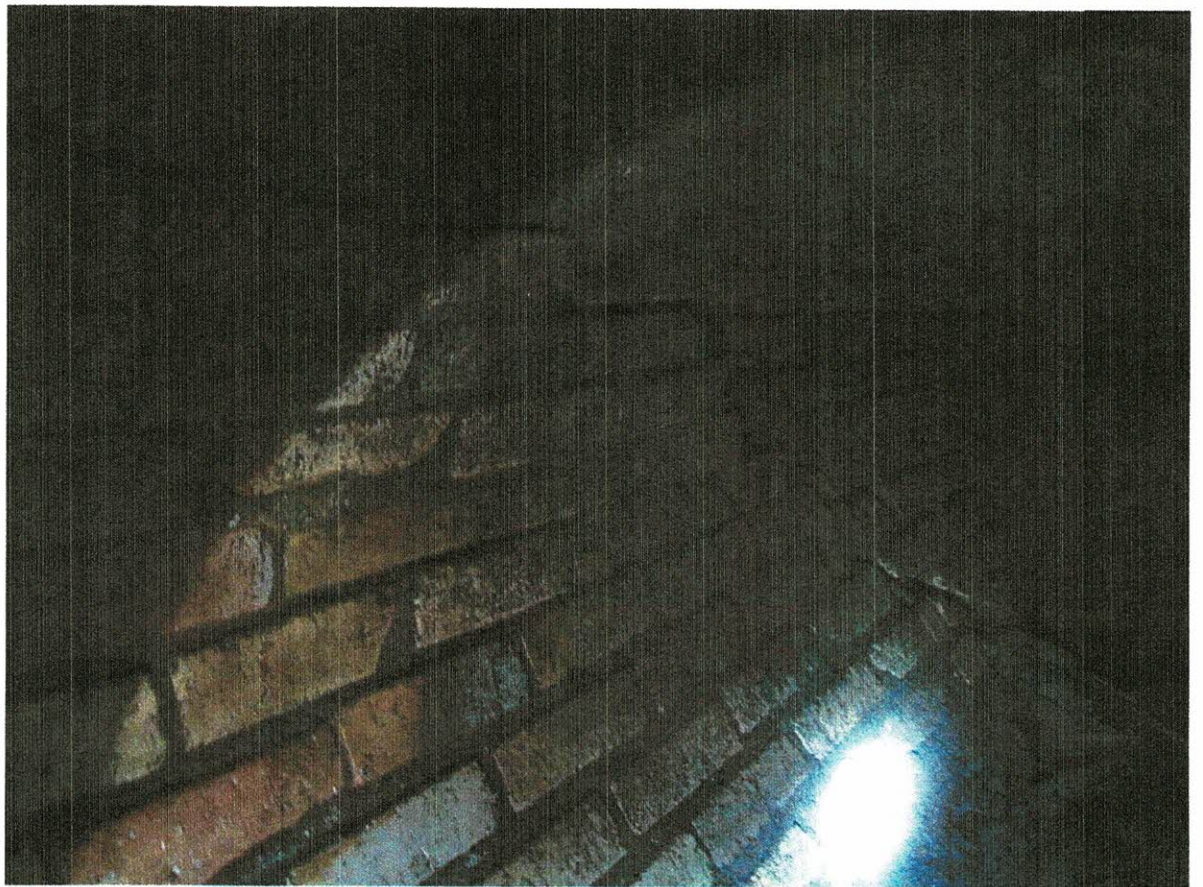
Rys. 8-9 Stan rozpatrywanego odcinka kanału S4-S5.
