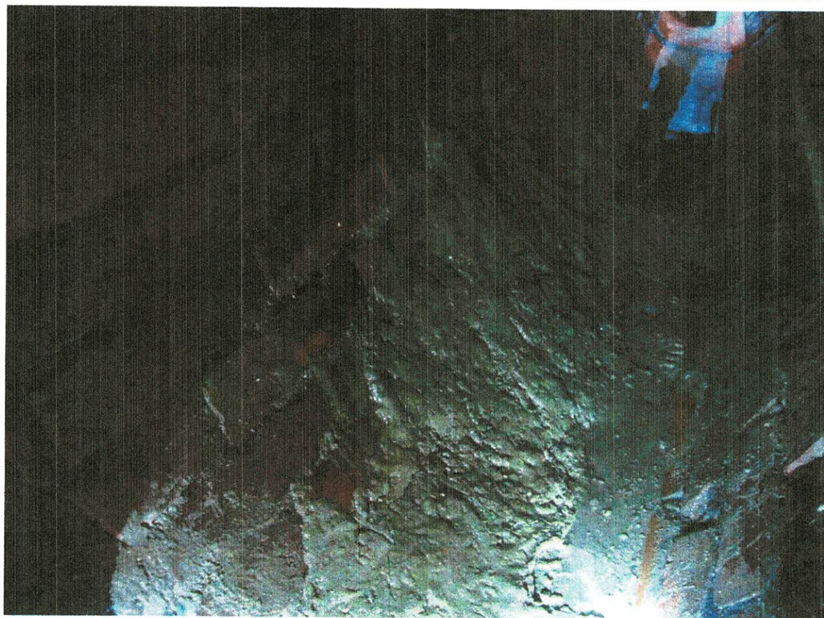
Rys. 10-11 Stan rozpatrywanego odcinka kanału S4-S5.
